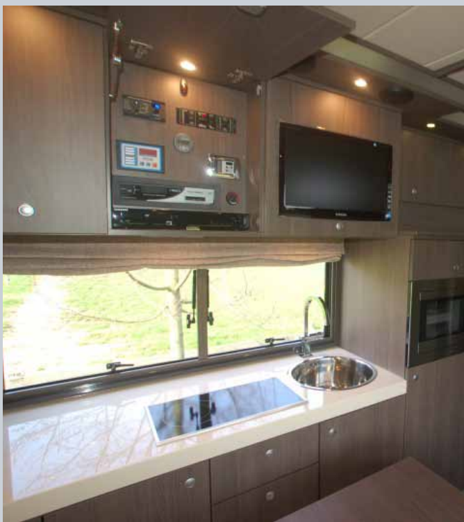
Foto 1: De BMV en Digital Multi Control Panel van Victron Energy, ingebouwd in de paardentruck.
